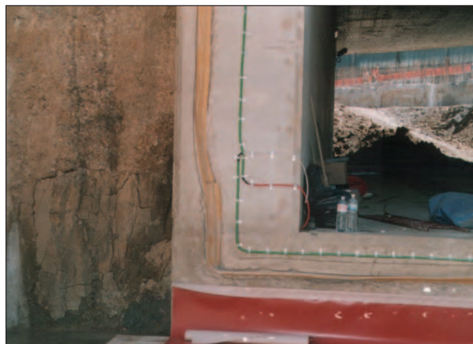
Schlecht eingebautes Fugenband muss mit Predimax® gesichert werden.
